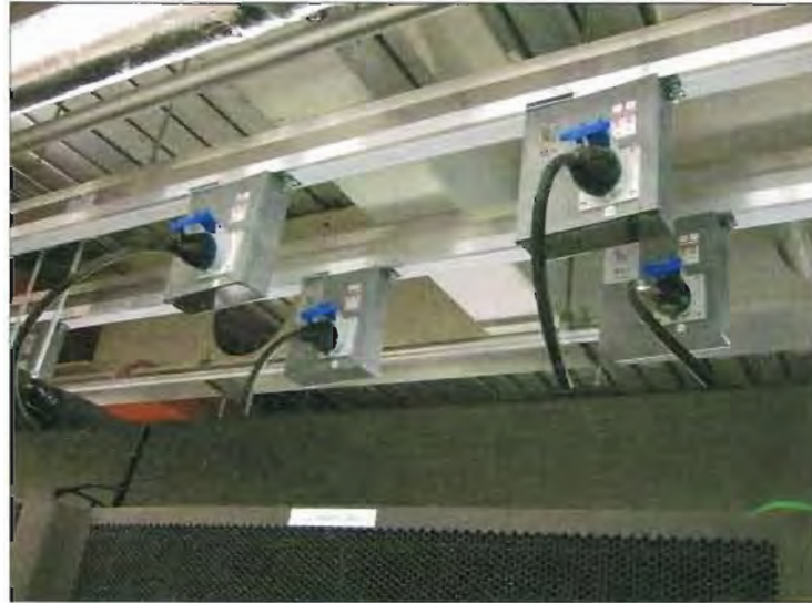
Ein schienenbasiertes, redundant aufgebautes Stromschienensystem versorgt die Racks eines Datacenters.
